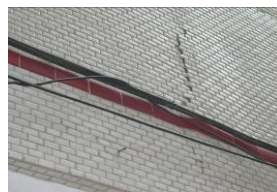
外牆立面龜裂
